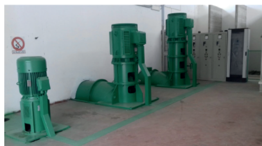
Impianto idrovoro Molinella: sala pompe - Vieste
