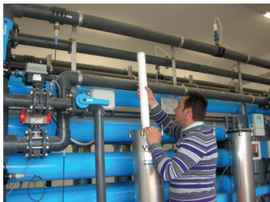
Particolare Impianto di osmosi
