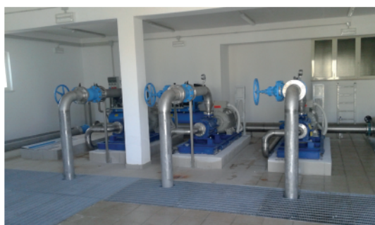
Stazione di Rilancio: gruppo pompe di sollevamento San Marco in Lamis
