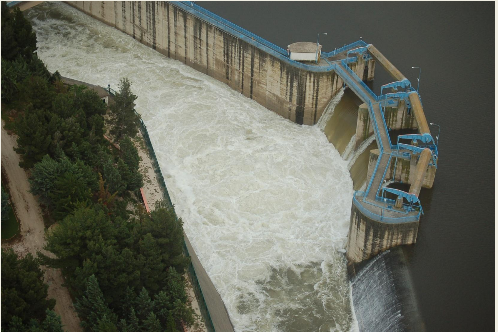
Invaso di Occhito. (particolare soglia fissa e paratoie automatiche)
